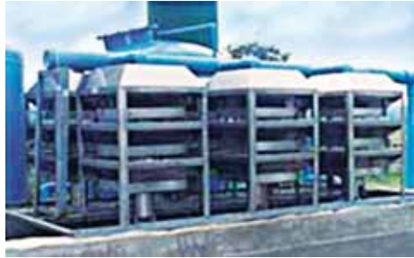
ระบบกำจัดสารละลายเหล็กในน้ำ (Aerator) System for removing iron solution in water (Aerator)
