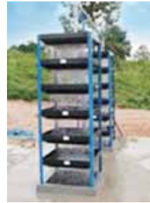
ระบบกำจัดสารละลายเหล็กในน้ำ (Aerator) System for removing iron solution in water (Aerator)
