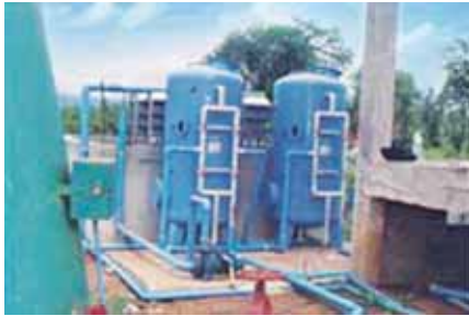
ระบบกรองสนิมเหล็ก (Sand Filter) Iron-rust filtration (Sand Filter)
